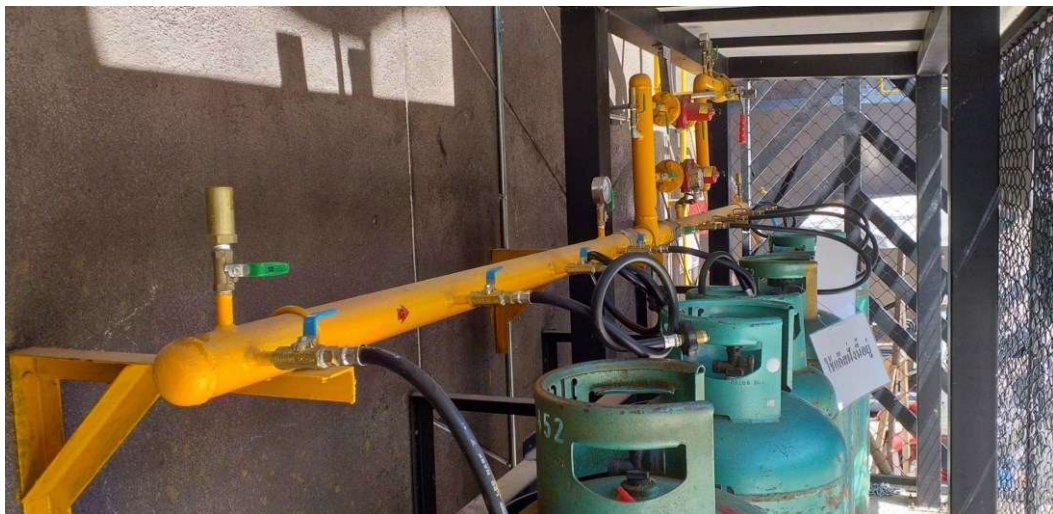
GAS SYSTEM / งานระบบแก๊ส
