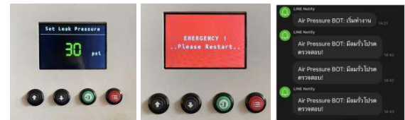
รูปที่ 9 การตั้งค่าความดันรั่วไหล การตัดการทำงานของปั๊มและการแจ้งเตือน
