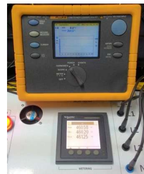
รูปที่ 6 การวัด %THDv ด้วยมิเตอร์ Fluke 1735
